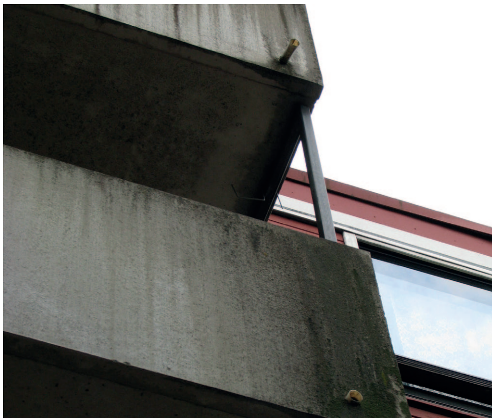
Parvekekorjauksissa ratkaisuja haetaan mm. parvekkeiden huonon, toimimattoman vedenpoistojärjestelmän sekä niukan mitoituksen aiheuttamiin ongelmiin.
