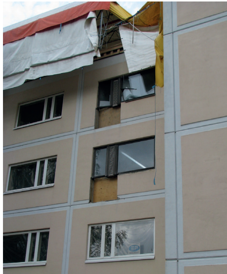
Julkisivukorjauksiin liittyy nykyisin usein paitsi parvekeasennuksia ja ikkunoiden uusimisia myös kattomuodon muutoksia.
