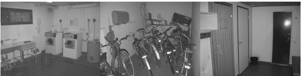
Kuva 35. Pesutupa on tilava. Virtakytkimille ulottuminen on hankalaa betonikorokkeen vuoksi.
